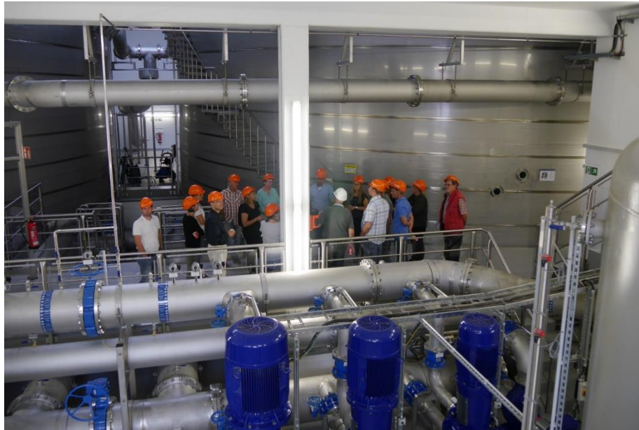
Besuch des Wasserwerks in Bexhövede (Foto Lothar Ernst)
